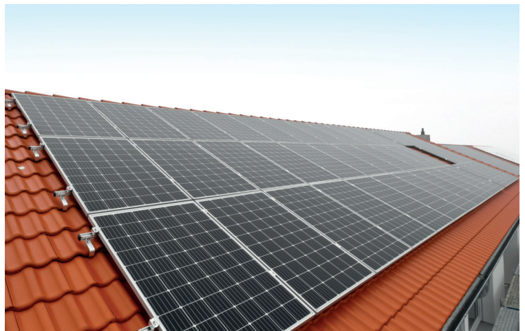
Inbetriebnahme Photovoltaikanlage Stoffelbergstr. 1, 3, 5, 89584 Ehingen
