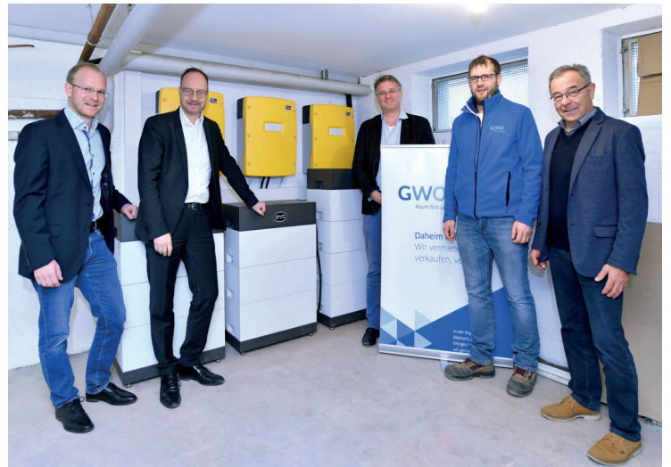
Inbetriebnahme Photovoltaikanlage Stoffelbergstr. 1, 3, 5, 89584 Ehingen
